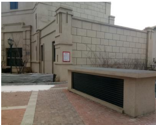
图 4-3 项目东边界排气口
