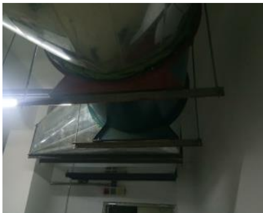
图 4-4 地下车库设备间内风机
