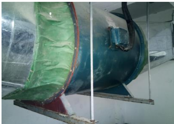
图 4-8 地下车库内风机
